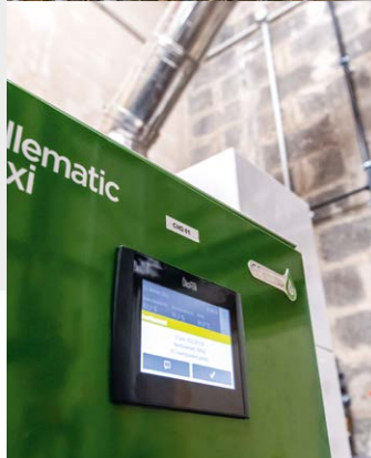
CHAUDIÈRE BIOMASSE DE LA MAISON DES HABITANTS D'ARLAC
